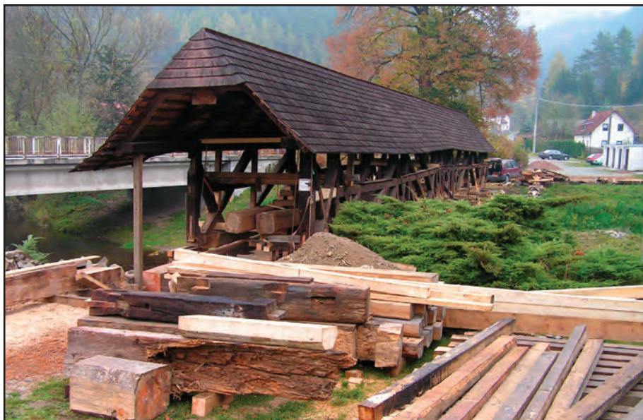
Obr. 2 Černvír (okr. Brno - venkov), dřevěný krytý most při opravě po sejmutí bednění. Foto Marta Procházková, 2008.
