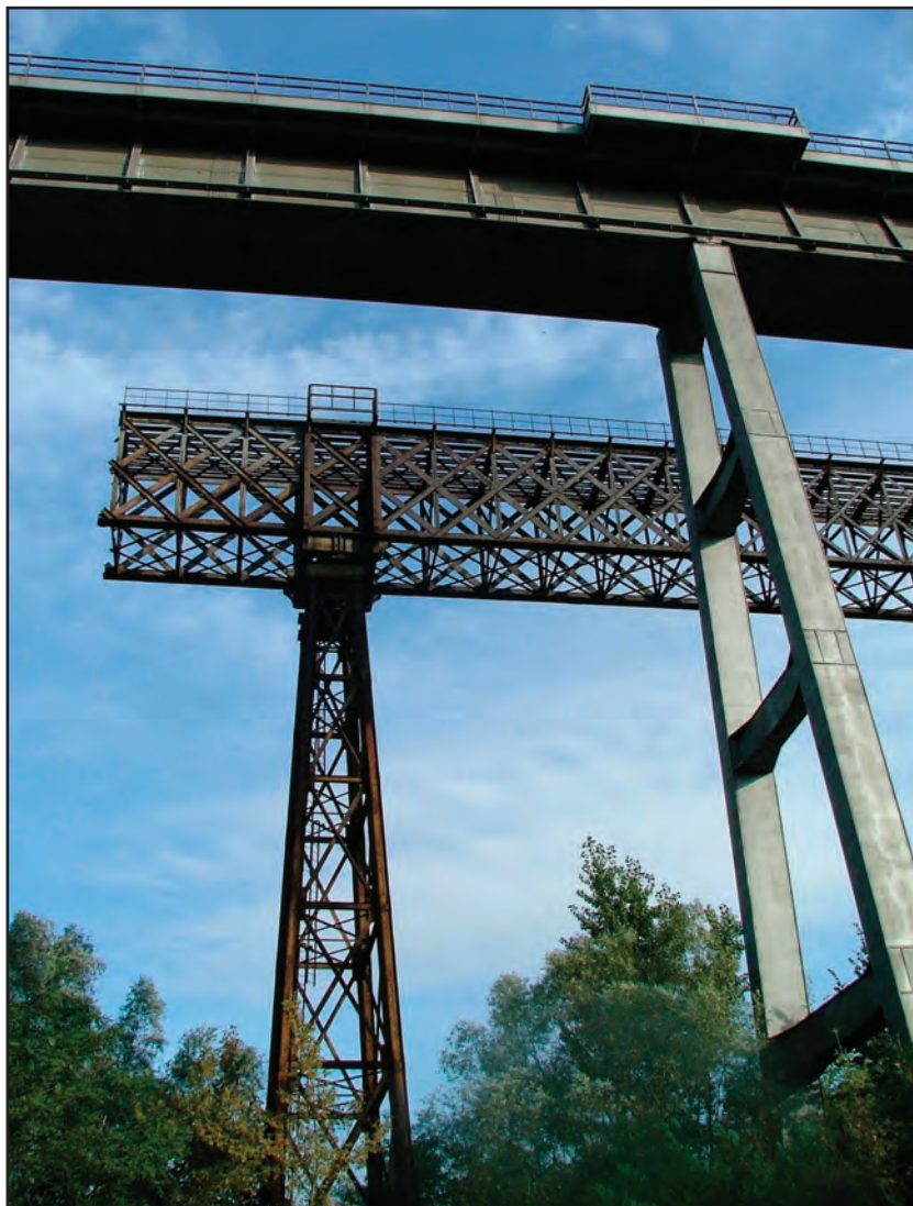
Obr. 6 Moravské Bránice (okr. Brno - venkov), torzo tzv. Ivančického viaduktu z roku 1870. Foto Tomáš Vícha, 2005.
