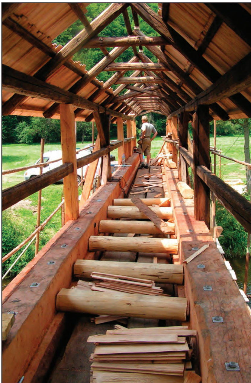
Obr. 6 Švařec (okr. Žďár nad Sázavou), průhled dřevěnou krytou lávkou při opravě. Foto Marta Procházková, 2006.
