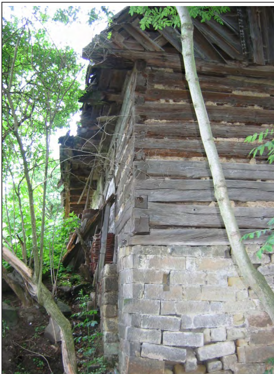
Obr. 6 Psinice (okr. Jičín), mlýn čp. 48. Staticky poškozené nároží návodní strany, stav před opravou. Foto Milan Smolík, 2004.
