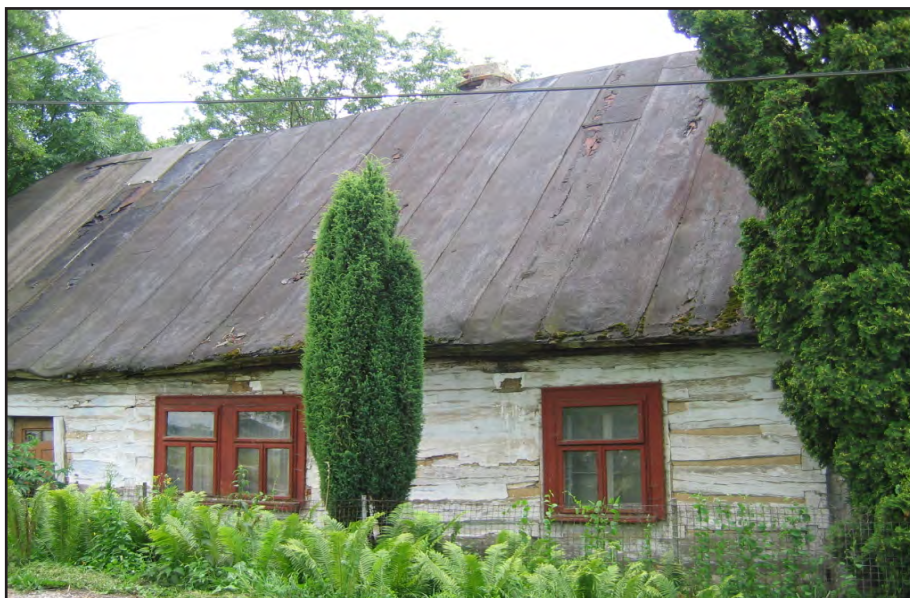
Obr. 3 Psinice (okr. Jičín), mlýn čp. 48. Stav před provizorní opravou střechy, nyní je zakryta novou asfaltovou lepenkou a krov je částečně provizorně vyrovnán. Foto Milan Smolík, 2004.
