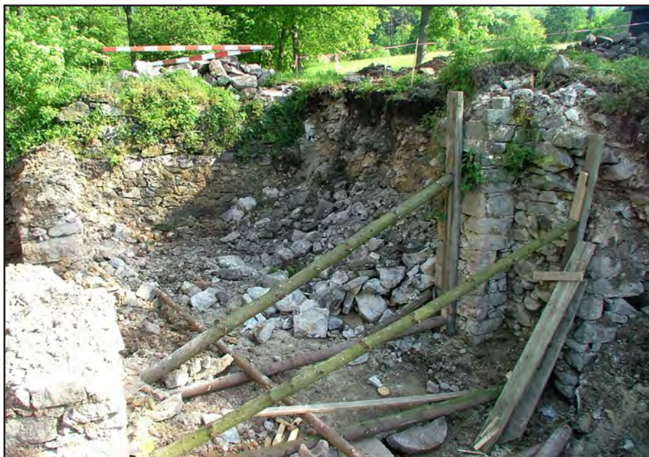
Obr. 1 Týniště (okr. Ústí nad Labem), pila u mlýna čp. 28. Zadní část suterénu pily po sesutí návodní zdi.
