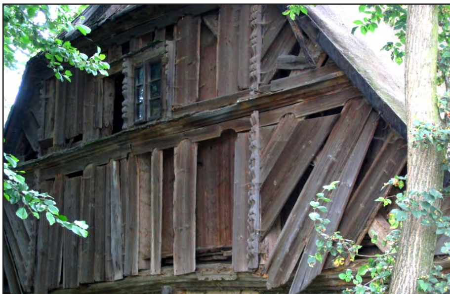
Obr. 5 Psinice (okr. Jičín), mlýn čp. 48. Bedněný štít návodní strany, poškozené prvky. Foto Milan Smolík, 2004.
