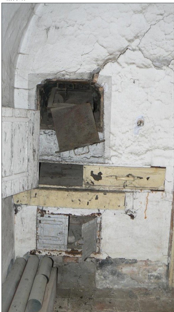
Obr. č. 4. Mravín, čp. 3, mladší trouba vsazená do boční strany zděné kuchyňské niky dymníkové kuchyně. Foto: Zuzana Vařeková,
