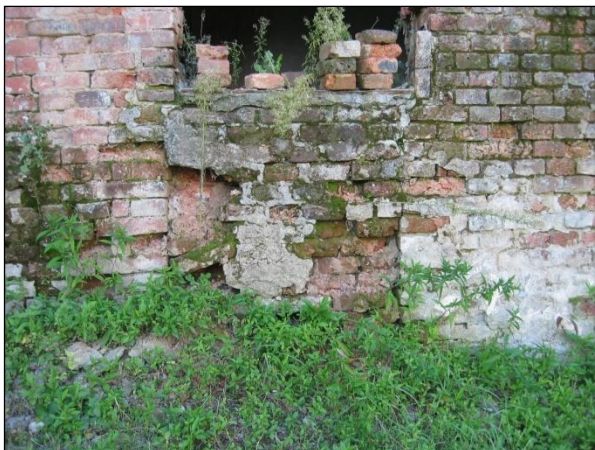
Obr. č. 7. Praha - Libeň, Pod Labuťkou č.p. 391/4, objekt s tehliarskou pecou. Zamurovaná časť južného nakladacieho otvoru. Foto: J. Čáni, 2013.
