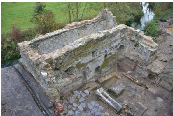
Obr. č. 15. Celkový pohled na stoupu ze skalního plató od jihu, obvodové zdivo lednice s patkou pro osazení segmentové klenby, vpředu interiér výrobního zařízení, u obvodové stěny odvodňovací žlab vysekaný v pískovcovém podloží. Foto I. Peřina 2012.
