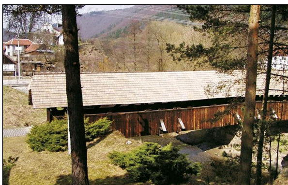
Obr. č. 1. Krytý most v Černvíru (ZR), stav před opravou v r. 2008. Foto V. Hunková, 2008.
