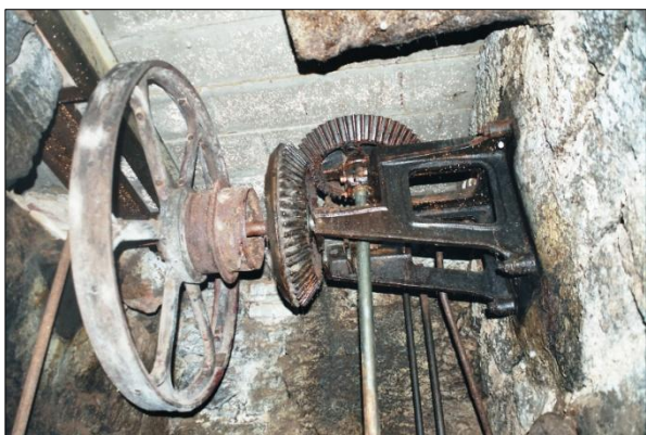
Obr. č. 20. Mariánská hora. Weberloch (okres Jablonec nad Nisou), brusírna čp. 567, pravoúhlý paleční převod od Girardovy turbíny. Foto: David Veverka, 2008.
