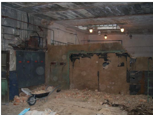
Obr. č. 17. Strojovna. Foto: Milan Starec,
